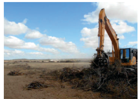
Controle de supressão - máquina realizando disposição e manejo do Topsoil e galhada fina.
