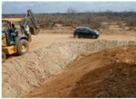
Controle de erosão e assoreamento - implantação do sistema de drenagem para coleta e direcionamento das águas
