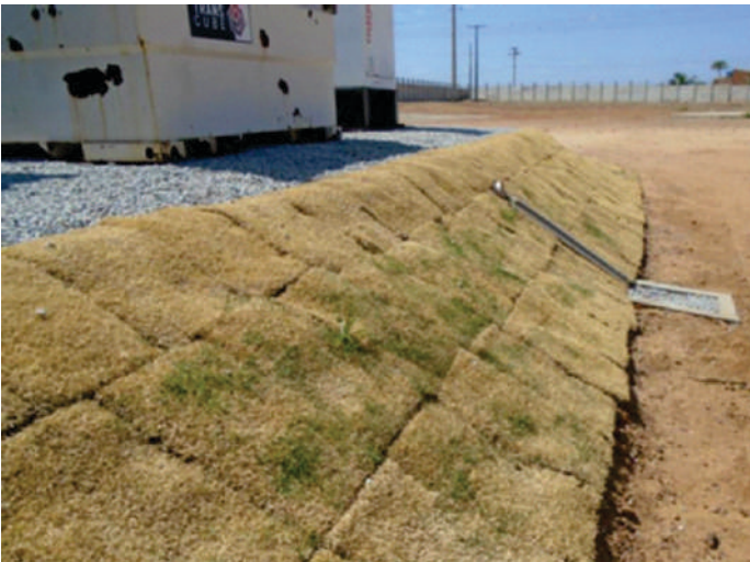
Exemplo de medida: plantio de gramínea e implantação de drenagem pluvial no talude.
